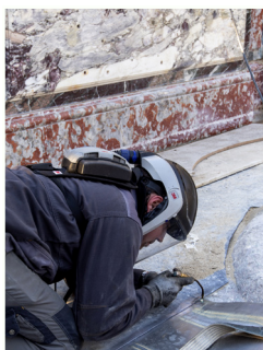
Pose d'un joint d'étanchéité dans une vasque © Château de Versailles © Didier Saulnier
